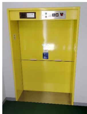
エレベーター
