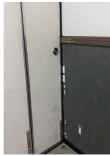
③パーテーション劣化
