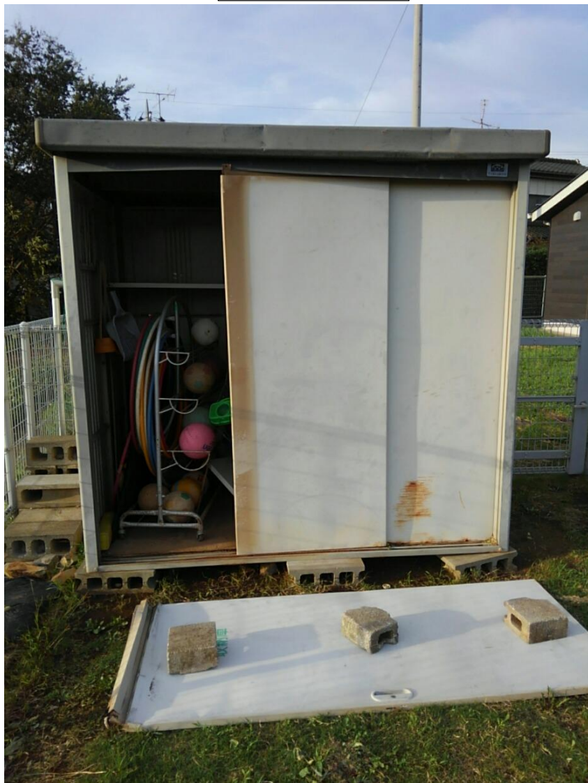
倉庫倒れ破損
