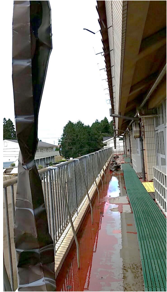
2階テラス雨樋破損
