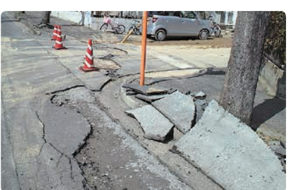
日吉台3丁目の被害
