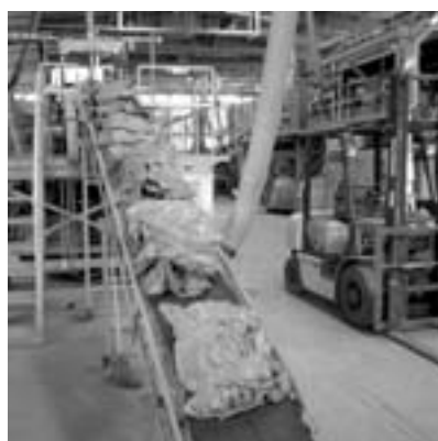
廃プラ処理施設
