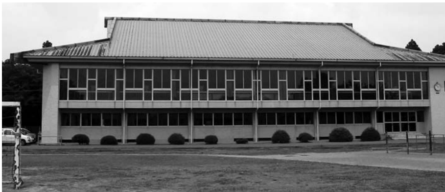
錆が目立つ南小体育館大屋根
