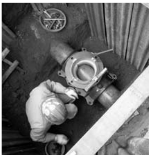
充実する下水道整備
