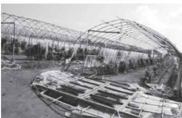
台風15号によるハウス被害 (十倉地先)
