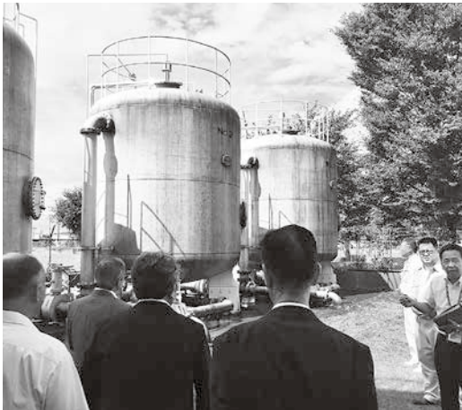
富里市水道事業所内ろ過機3機
