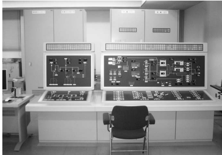
改修を終えた配水盤
