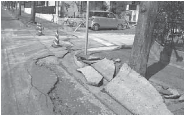
▲一部市道では、大規模な破損が発生しました。
